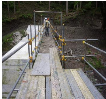
転落防止対策
